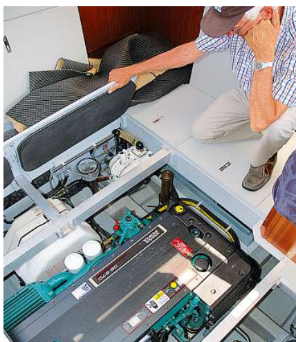
Volvo Pentas 272 kW starker D6-370 werfelt gut gedämmt unter dem Salonboden
